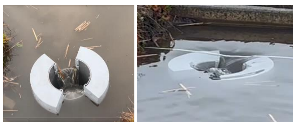
写真-2 浮遊ゴミ排出状況、全周越流時の余水吐機能
